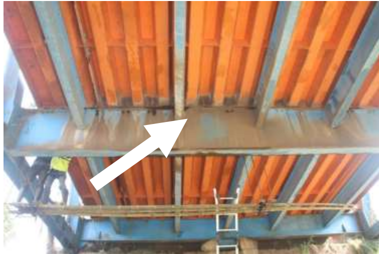
Gambar 22. Daerah yang terjadi kebocoran antar sambungan pelat ortotropik
