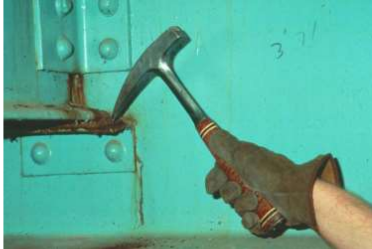
Gambar 6. Pemeriksaan korosi pada baja
