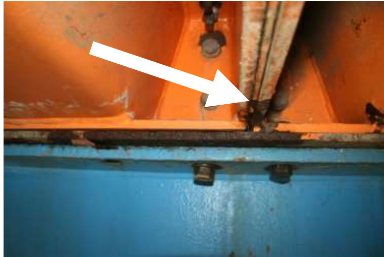
Gambar 16. Kondisi cat yang tipis pada bagian tepi dan sudut tajam
