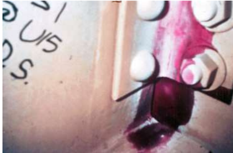
Gambar 24. Pendeteksian retak menggunakan dye penetrant
