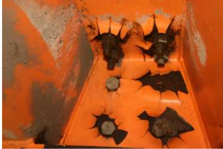
Gambar 20. Karat pada kepala baut
