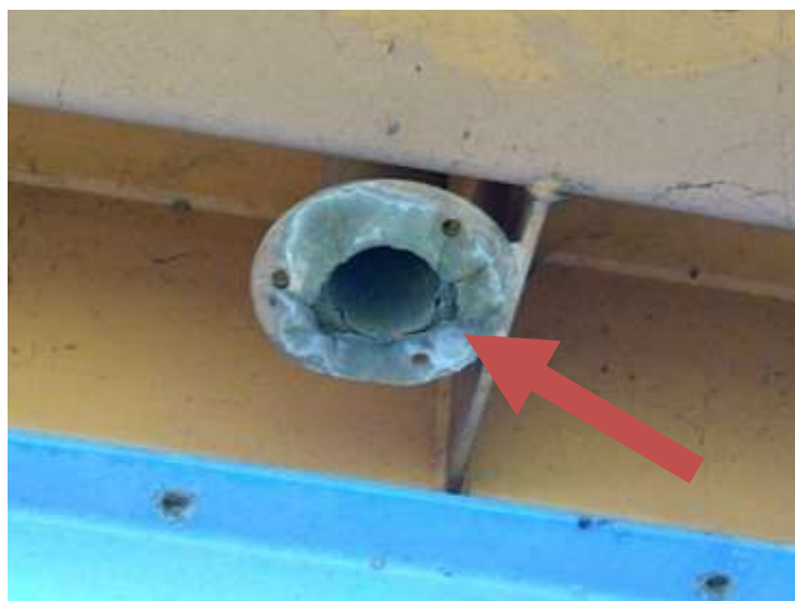
Gambar 9. Korosi pada pipa drainase
