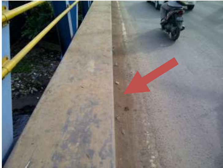
Gambar 7. Lubang drainase yang tertutup kotoran
