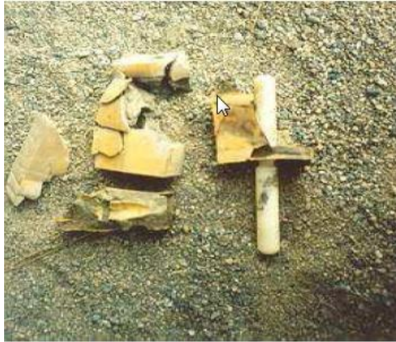
Gambar B.3 - Kerusakan akibat fatik (kelelahan) pada komponen angkur baja dari sambungan siar muai
