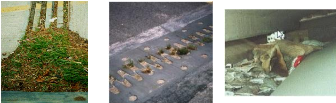
Gambar B.1 - Sampah dan vegetasi pada sambungan siar muai
