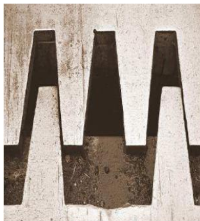
Gambar B.4 - Kerusakan akibat fatik (kelelahan) pada komponen finger dari sambungan siar muai
