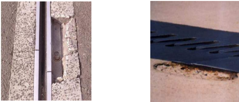
Gambar B.2- Kerusakan berupa gompal pada sambungan siar muai
