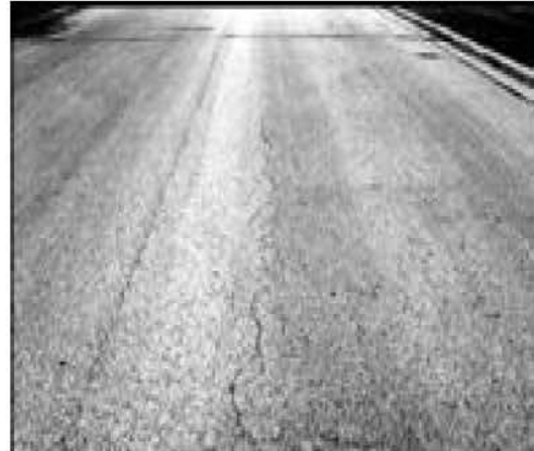
b. Retak halus/retak rambut
