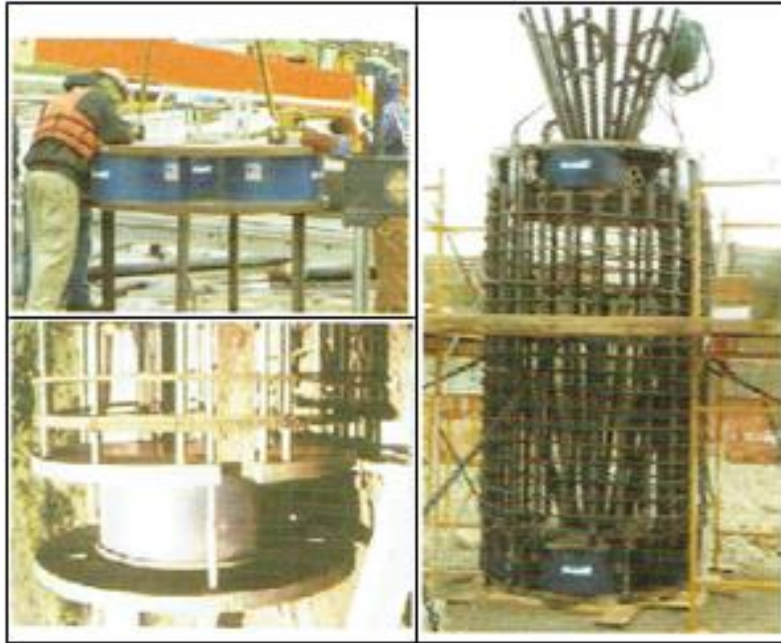
Gambar 4.42 - Jack yang ditempatkan didasar (gambar kiri bawah), pemasangan beberapa jack (gambar kiri atas) dan pemasangan multi level jack (gambar kanan)
